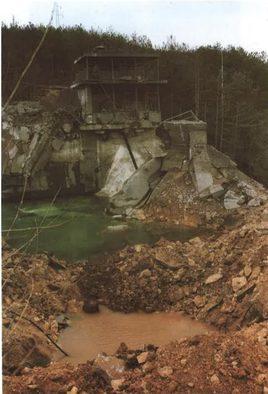
Slika 10: Oštećenje lijevog kraja brane (Izvor: [4])
