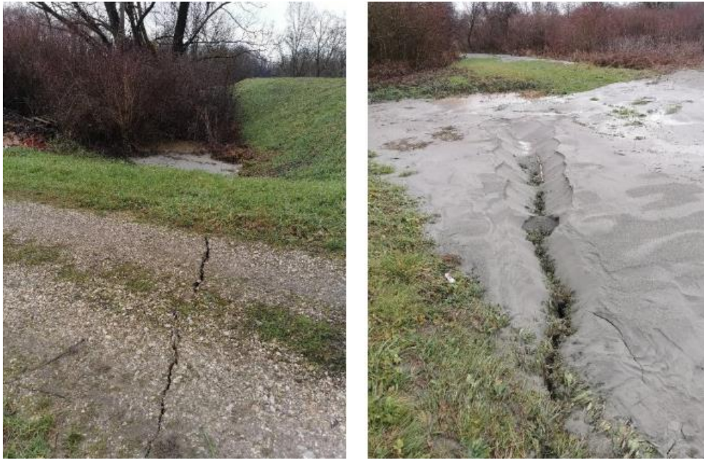
Slika 20.:Likvefakcijske pukotine (Izvor: [12])
