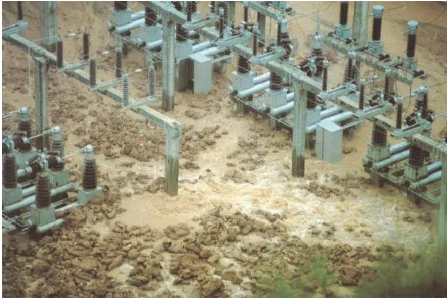
Slika 12: Rasklopno postrojenje HE Peruća (Izvor: [4])
