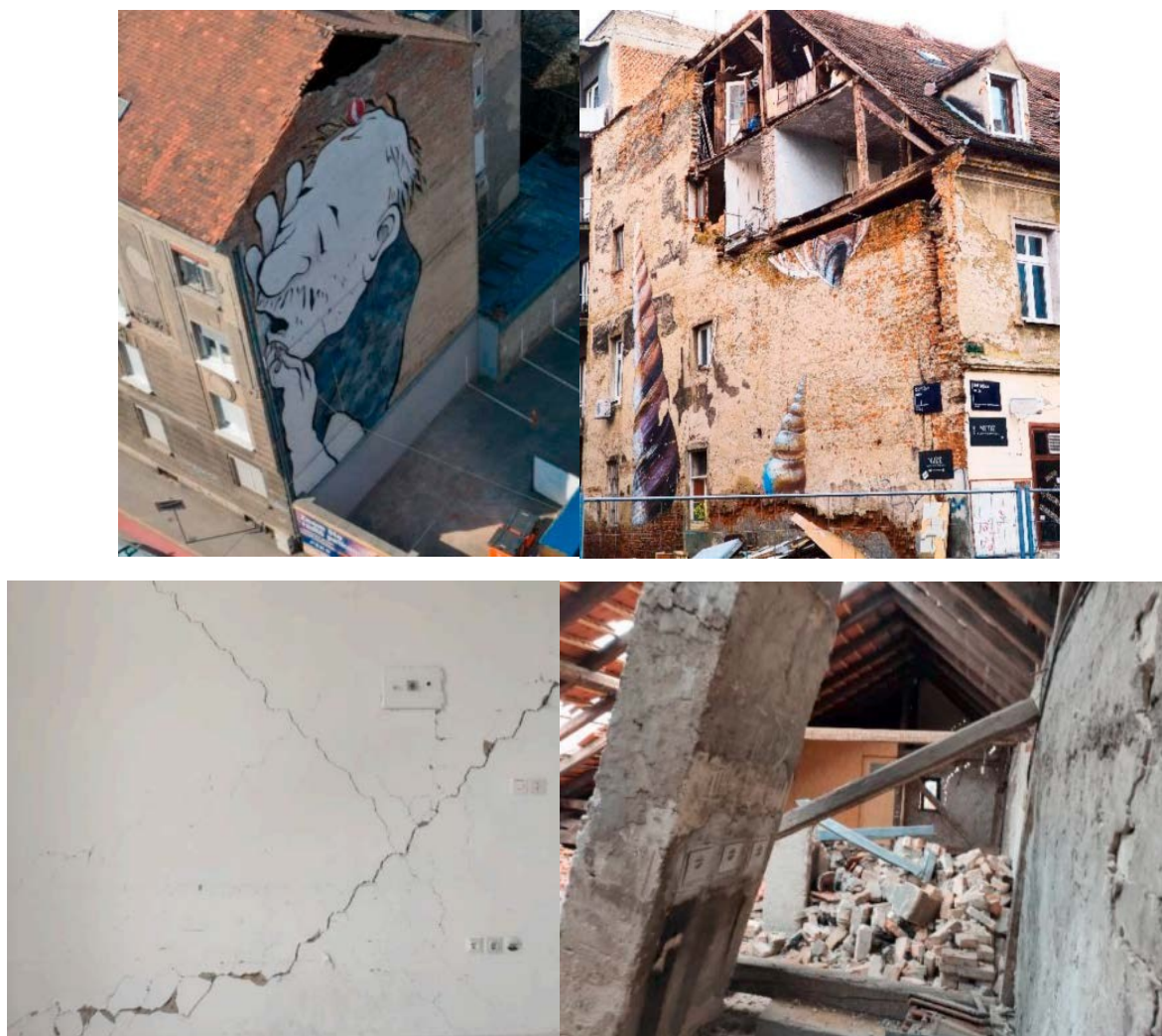
Slika 11: Primjer vanjskih i unutarnjih oštećenja u Zagrebu (2)
