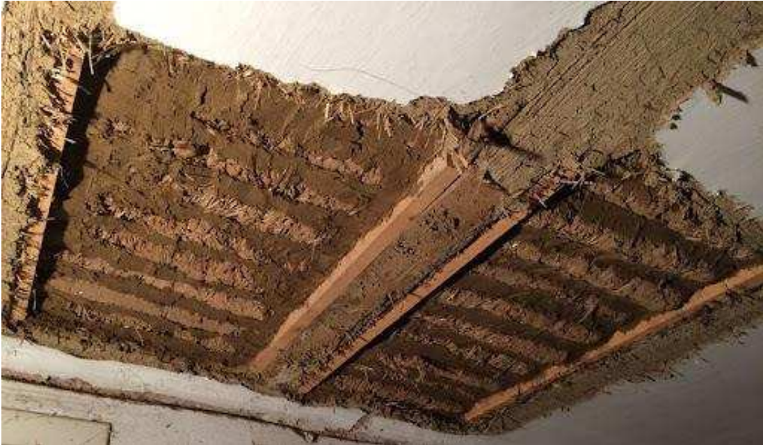
Slika 37: Oštećeni podgled stropa od ilovače
