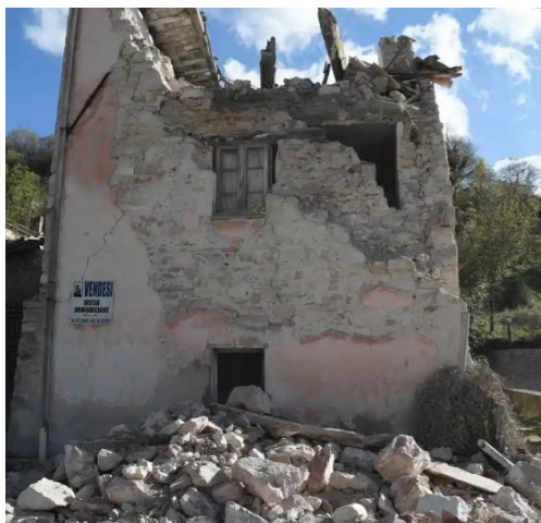
Slika 9. Djelomično prevrtanja zida nakon potresa u Italiji [15]
