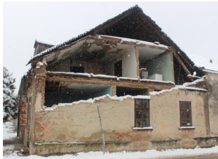
Slika 8. Djelomično prevrtanje zida nakon potresa u Petrinji 2020. godine [5]
