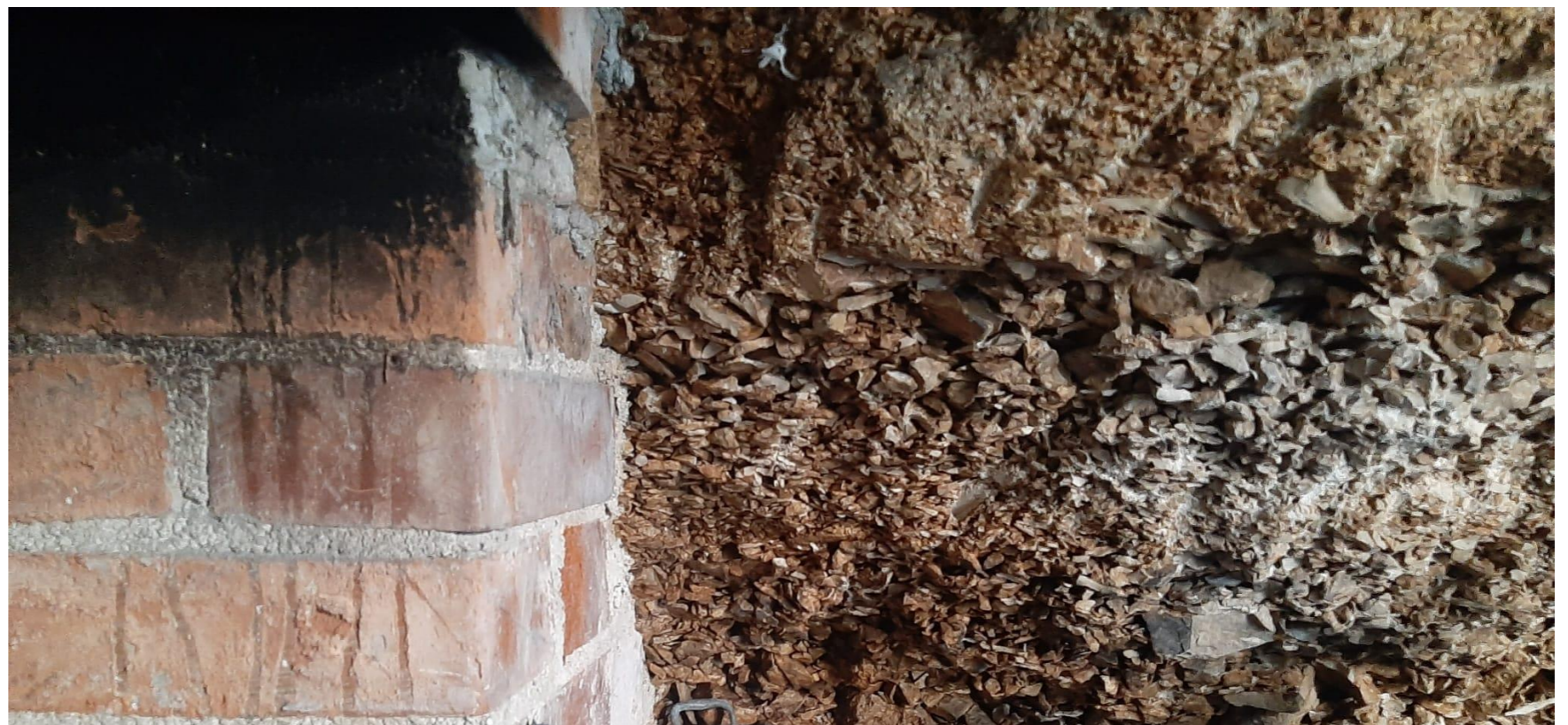
Slika 21: detalj spoja opeke s hrpaćušom
