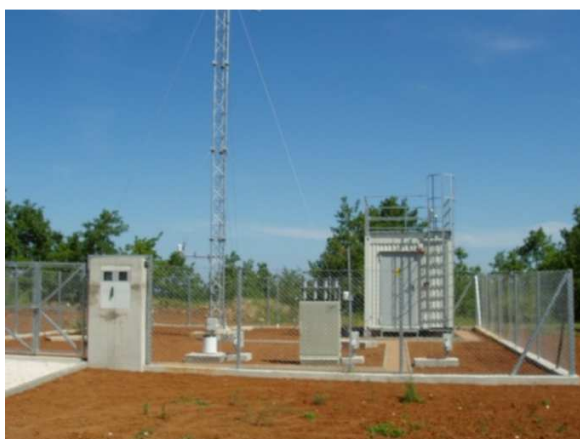
Slika 3.1.1.1. Fotografija automatske mjerne postaje Višnjan [12]
