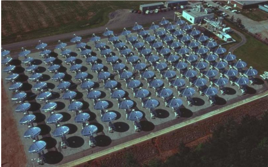
Slika 2.4. – Elektrana solarnih tanjura u Shenandoah, Georgia [2]
