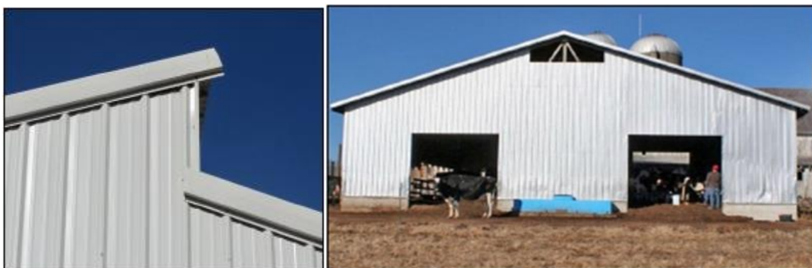
Slika 17. Otvoreni grebeni na krovu za prirodnu ventilaciju zraka (Bewley i sur., 2012)
