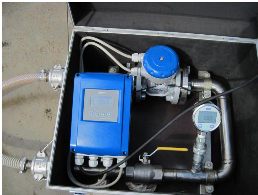
Slika 15. Uređaj za kontrolu protoka crpke Krohne
