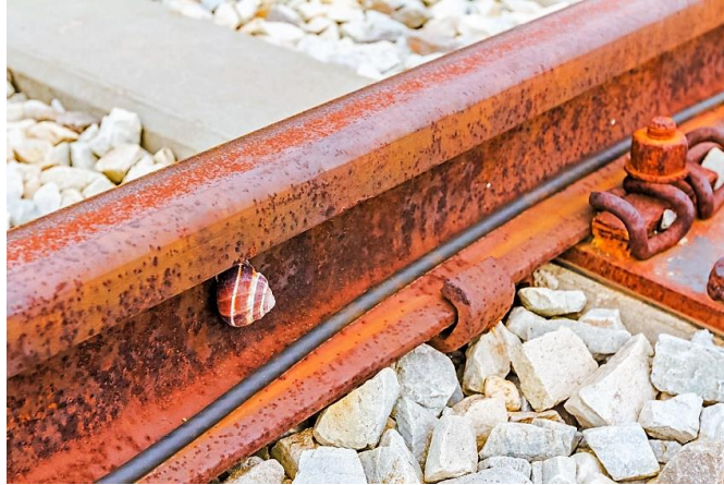
Slika 5. Elektrokemijska korozija tračnice i spojeva željezničke pruge
