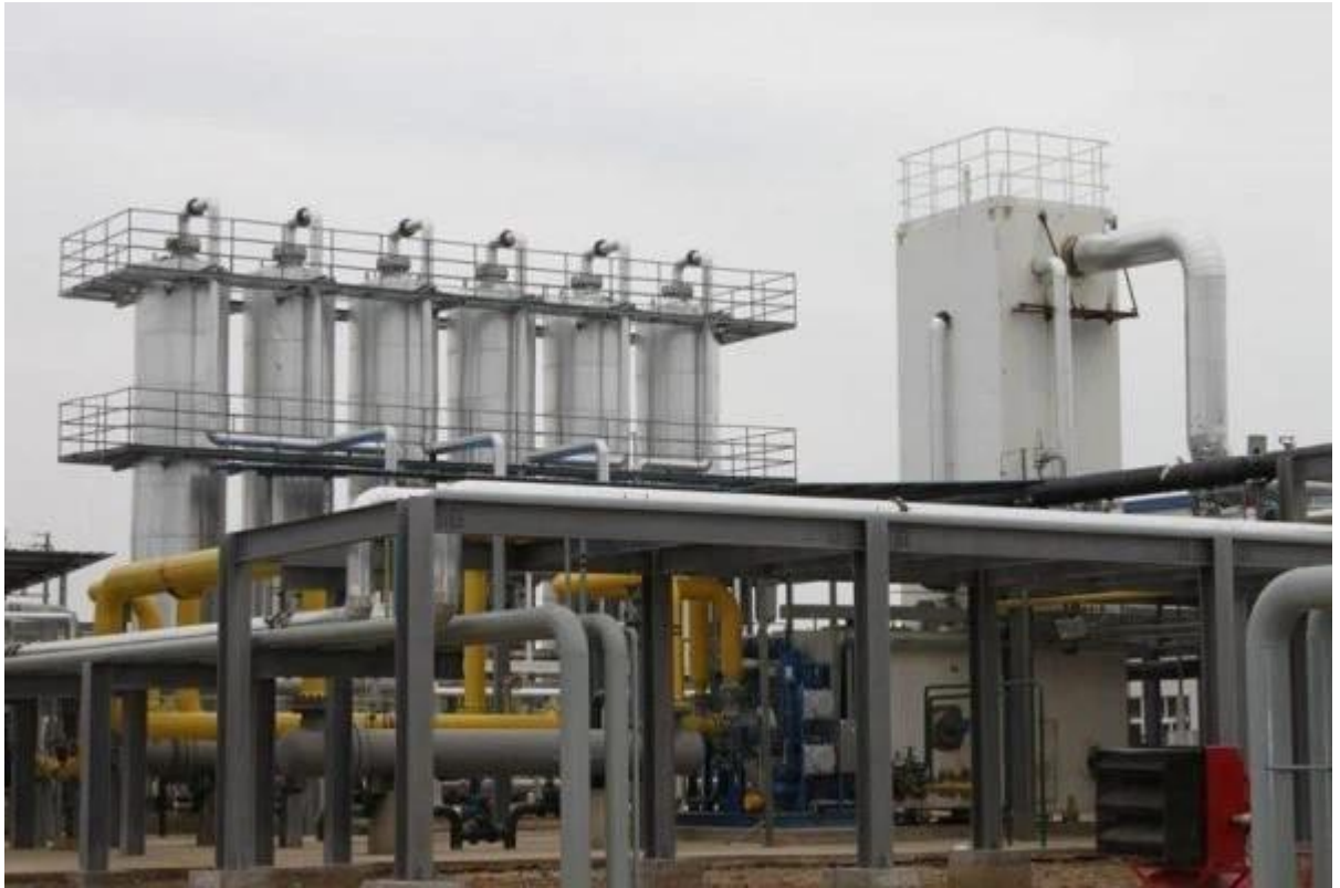
Slika 5: Postrojenje za pročišćavanje i ukapljivanje prirodnog plina
