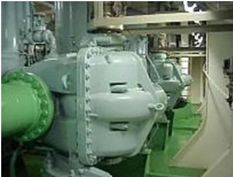
Slika 4. Glavne pumpe tereta
