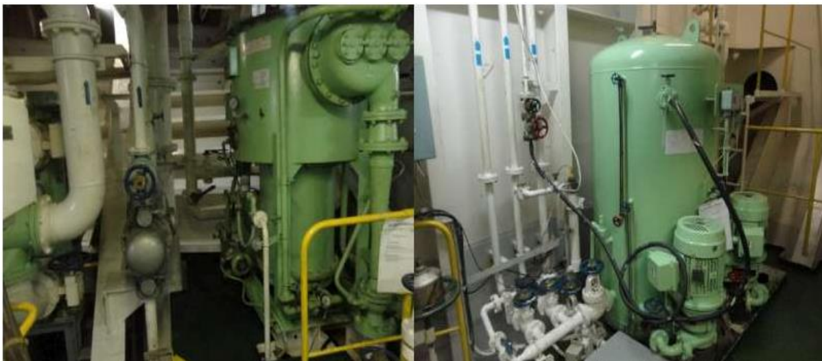
Slika 5. Generator slatke vode na LNG brodu [11]
