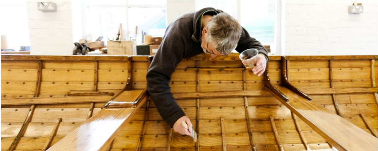
Slika 47. Jedna od faza brtvljena drvene konstrukcije po West sistemu (zaštita epoksidnom smolom) drvene gradnje
