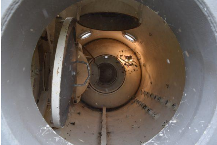
Slika 23. BL zamjenjuje čovjeka u nadzoru brodske infrastrukture
