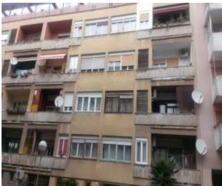
Slika 8.: Pročelja prije obnove
