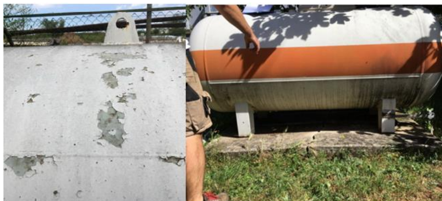
Slika 3-14. Oštećenja spremnika za ukapljeni naftni plin ( http://e-glasnik.tuv-croatia.hr/index.php/tehnicka-inspekcija/item/205-unp-spremnici )
