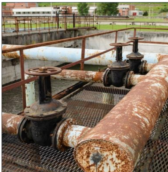
Slika 3-9. Primjer opće korozije ( https://corrosioncollege.com/resources/white-papers , 29.07.2020.).
