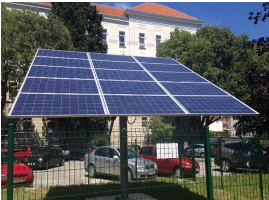
Slika 7.1. Sustav fotonaponskih panela na Tehničkom fakultetu u Rijeci[20]
