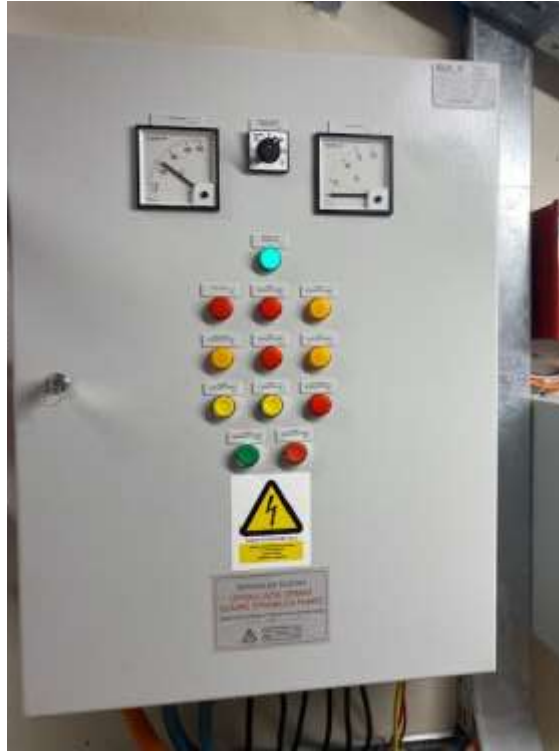
Slika 16. Upravljački ormar glavne sprinkler pumpe
