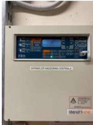
Slika 15. Sprinkler nadzorna centrala
