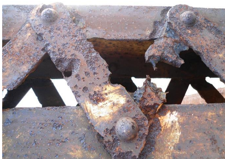
Slika 11. Primjer pjegaste korozije poprečnog nosača mosta [14]
