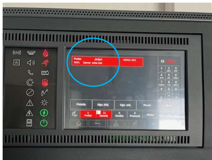
Slika 32. Vatrodojavna centrala signalizira požar
