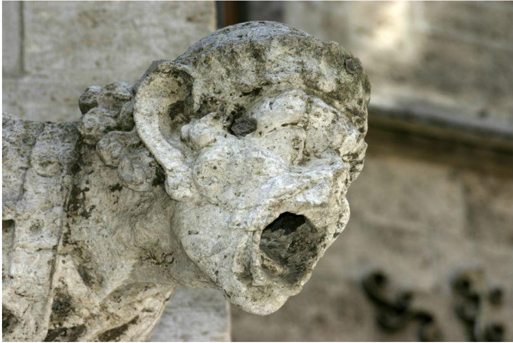
Slika 6. Oštećenje betona pod utjecajem kiselih kiša ( http://www.ekokutak.zivotinje.rs/single.php?alias=evropa-nam-cuva-prirodu&id=10943 )
