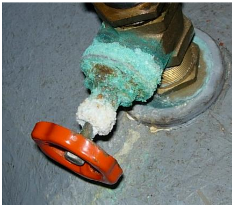
Slika 1.10 Selektivna korozija ventila [14]
