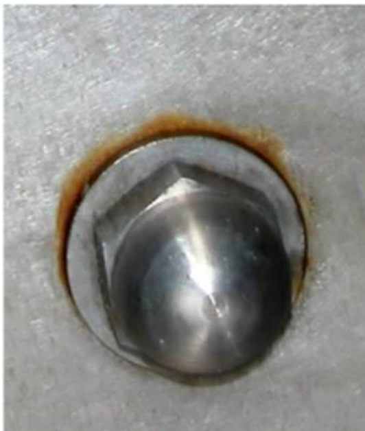
Slika 2.15 Korozija u rasporu između podloške i materijala [32]
