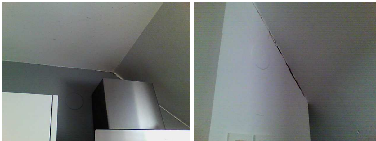
Slika 26. Pukotine gipskartonskih obloga
