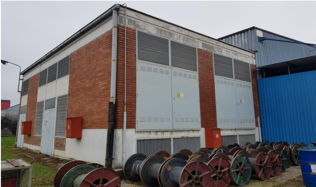
Slika 11. Transformatorska stanica snage 1 MVA
