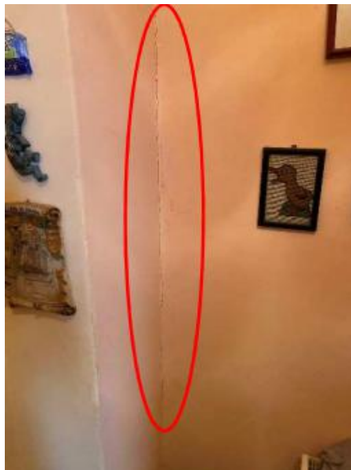
Slika 5.36. - Vertikalna pukotina na spojevima zidova
