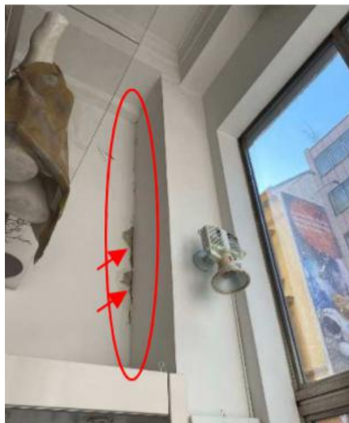
Slika 5.5. - Indikativna vertikalna pukotina na krajnjem istočnom zidu
