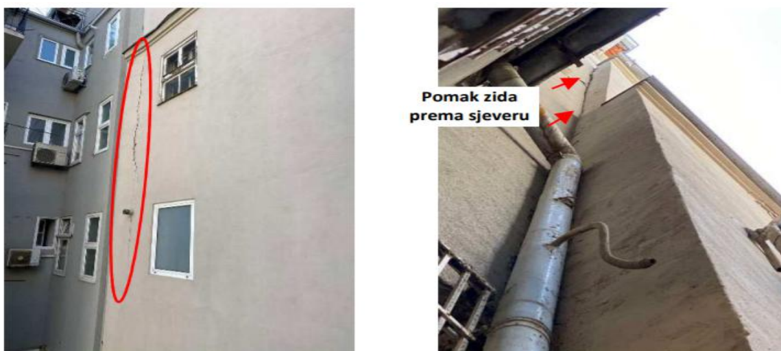
Slika 5.57. - Vertikalna pukotina na istočnom nosivom zidu
