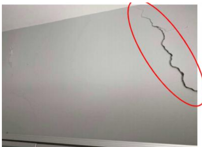
Slika 5.9. - Pukotina na pregradnim zidovima unutrašnjosti stana
