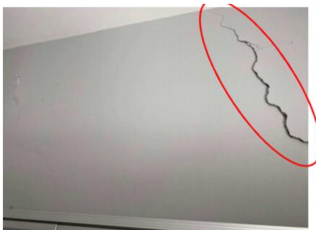
Slika 5.9. - Pukotina na pregradnim zidovima unutrašnjosti stana
