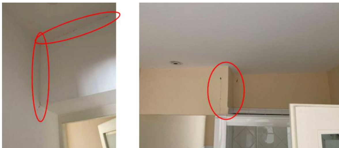
Slika 5.7. - Vertikalne i horizontalne površinske pukotine
