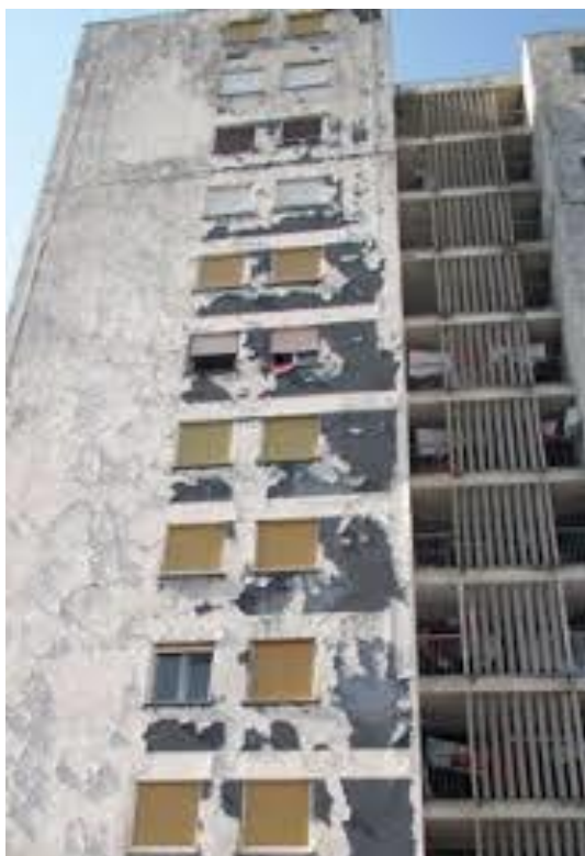
Slika 2.2.1, Propadanje građevine od djelovanja vanjskih utjecaja
