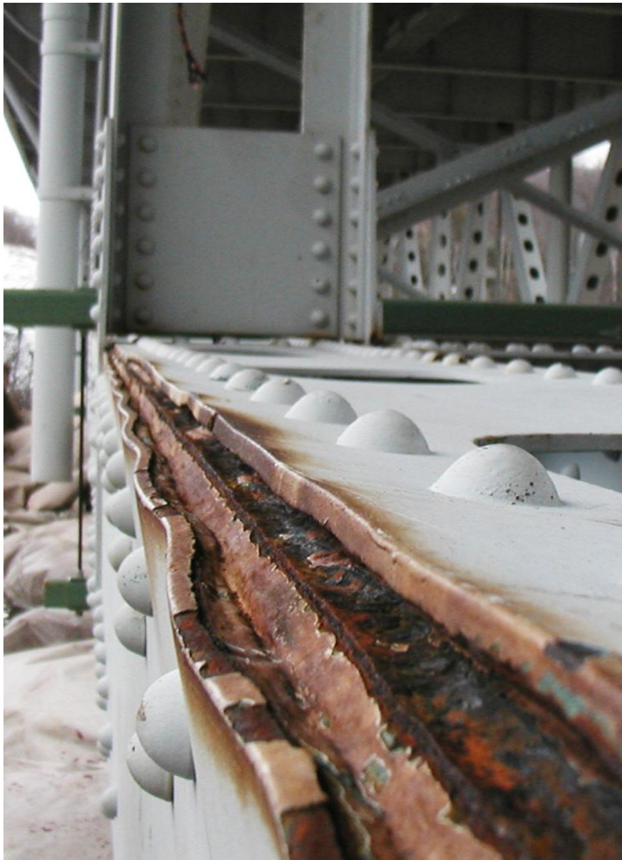
Slika 4.16 Korozija u procijepu između dva jednaka metala nastala na konstrukciji mosta [30]
