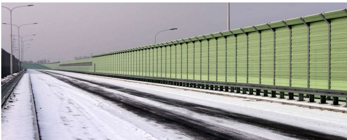
Slika 7 Aluminijski paneli za zaštitu od buke
