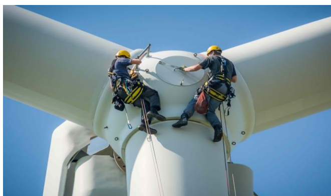
Slika 6. Prikaz održavanja vjetroelektrane
