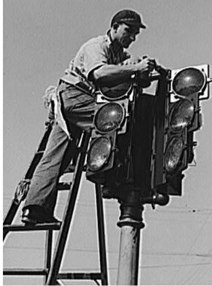
Slika 13 Instalacija prometnih svjetala u San Diegu 1940. godine
