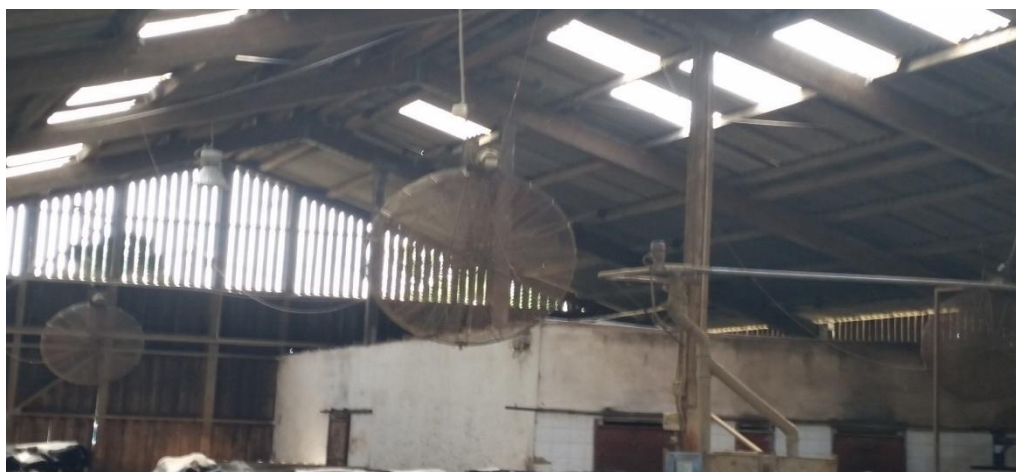
Slika 11. Ventilatori na OPG – u
