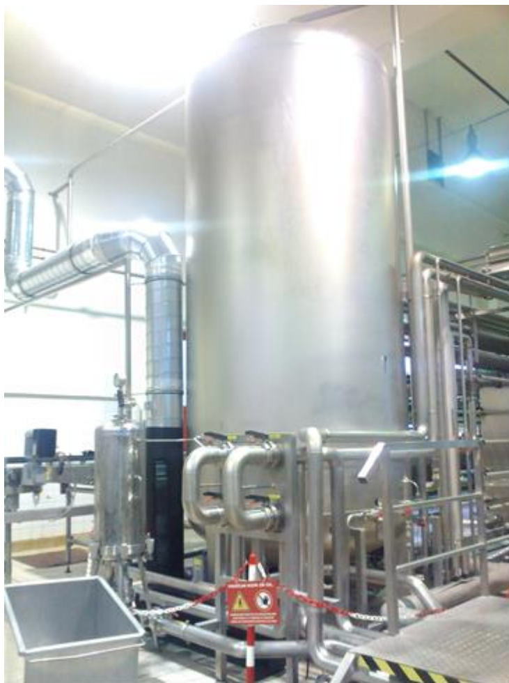
Slika 16. Pufer tank „Fischer“ protočnog pasterizatora
