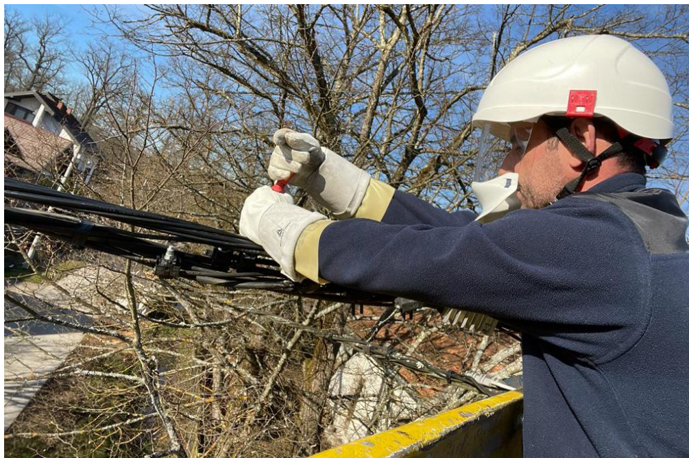
Slika 24. Spajanje priključnog kabela svjetiljke na vod javne rasvjete u sklopu izoliranog samonosivog kablenskog snopa [Vlastiti izvor]
