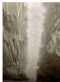
Slika 4. PT zavara između ploča brtvene stijene
