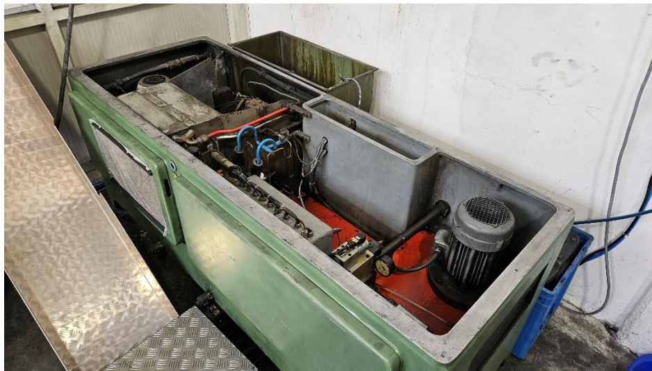
Slika 28. Izgled kućišta hladnjaka prije ugradnje novog sustava [Autor]
