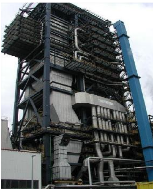
Slika 13. Kotlovsko postrojenje TE Plomin 2. [17]
