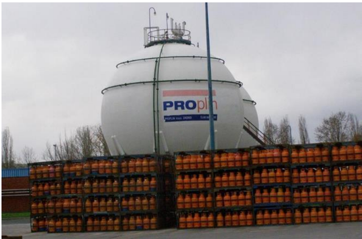
Slika 3. Sferni spremnik u krugu postrojenja [2]
