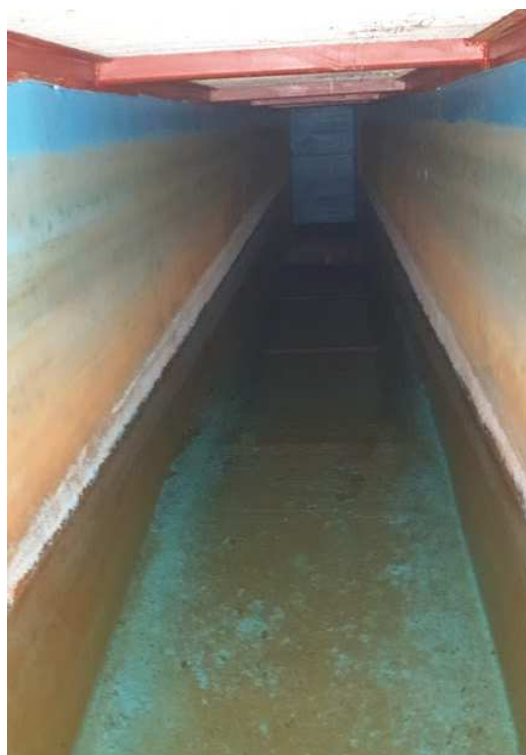
Slika 19. Dužina kanala [i.a.]
