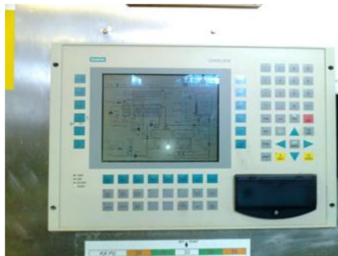
Slika 15. Operacioni panel „Siemens“
