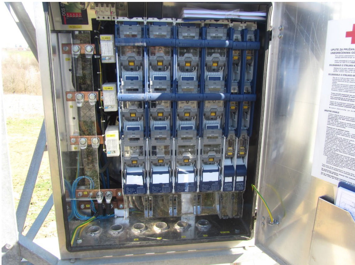
Slika 5 Razvodni ormarić trafostanice za distribuciju
