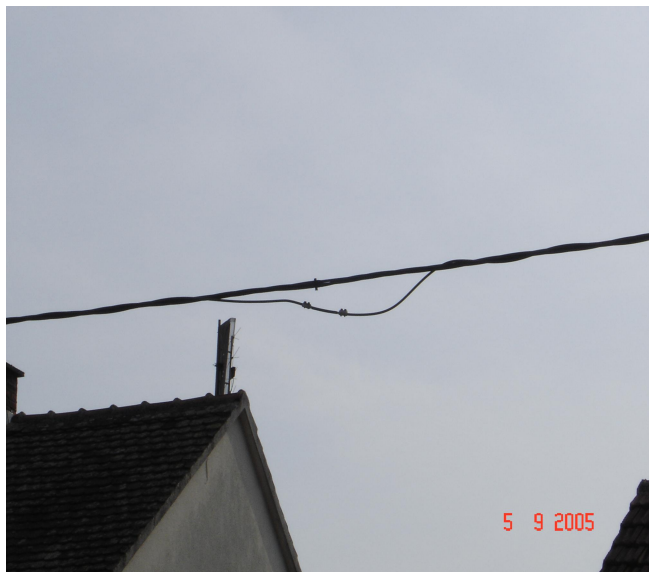
Slika 20. Primjer oštećenog vodiča [Vlastiti izvor]
