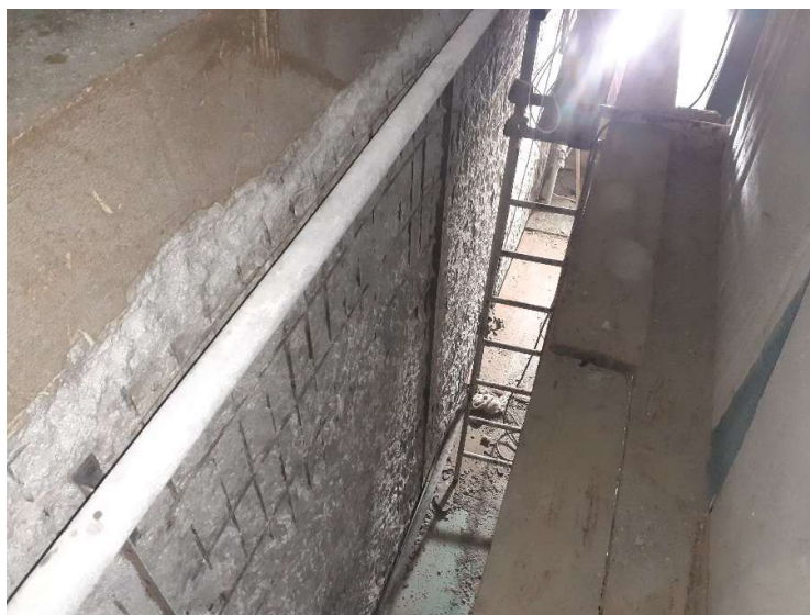
Slika 4.24 Brtveća stijena nakon uklanjanja površinskog sloja betona
