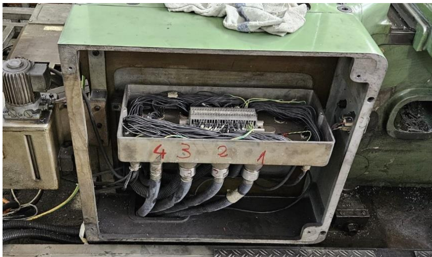
Slika 23. Potreban poklopac instalacija[Autor]
